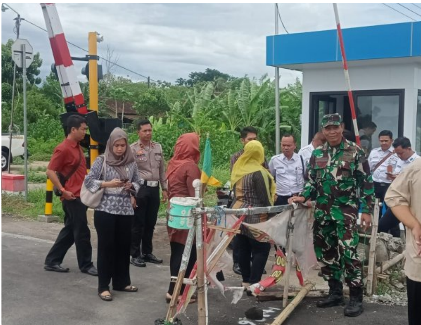
Danramil Wonosari Bersama Muspika Wonosari Tinjau Pembangunan Pos Pengamanan Palang Pintu Perlintasan Kereta Api Desa Boto Klaten
